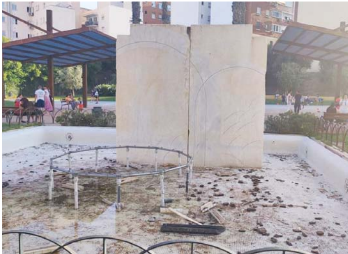
Éste es el estado actual en el que se encuentra la fuente para la que piden una solución. VECINOS NUEVA MÁLAGA
